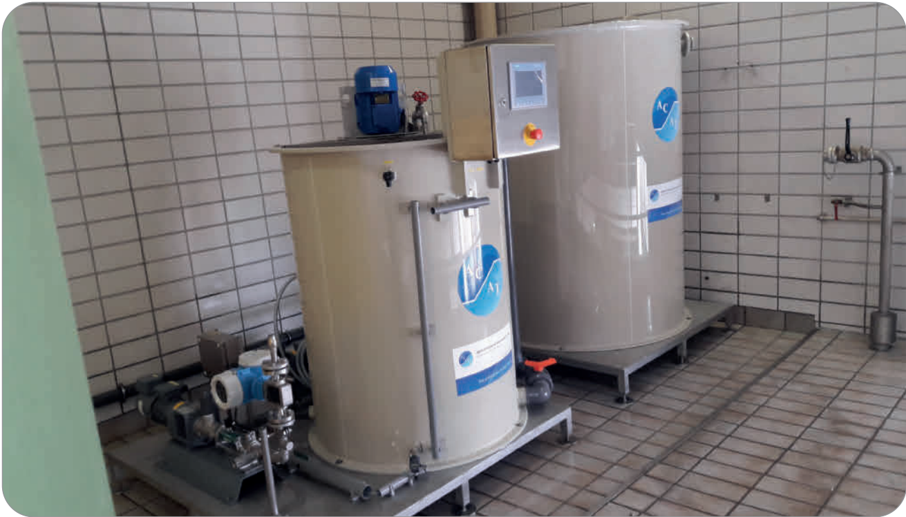
AWV Hall in Tirol – Fritzens Polymerlösestation FPU für Schlammeindickung mittels Bandeindicker
