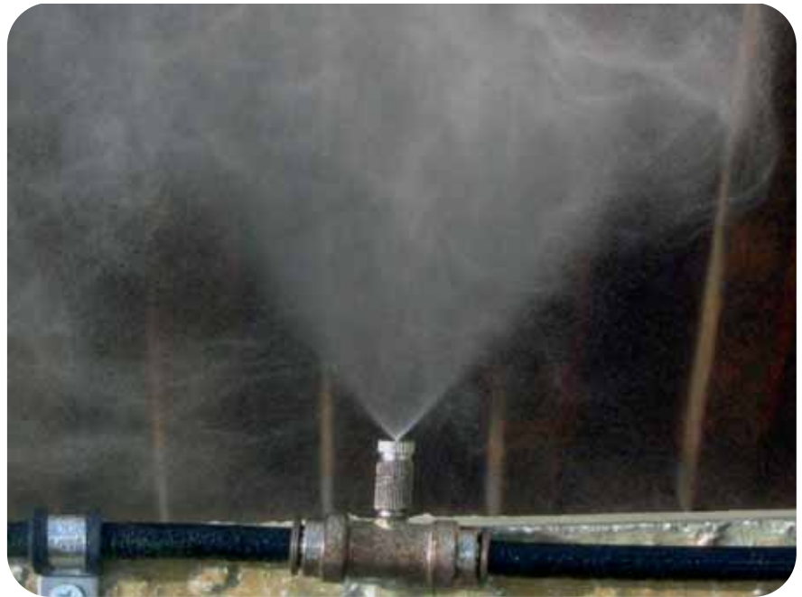
Eine Leitung mit eingebauten Düsen wurde installiert; das Bild zeigt eine einzelne Düse
