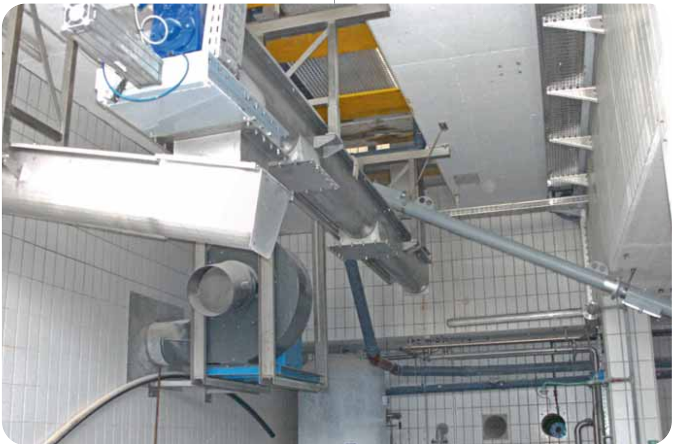
Spiralfördertechnik (inklusive Nachkalkung) für den Austrag des entwässerten Klärschlammes
