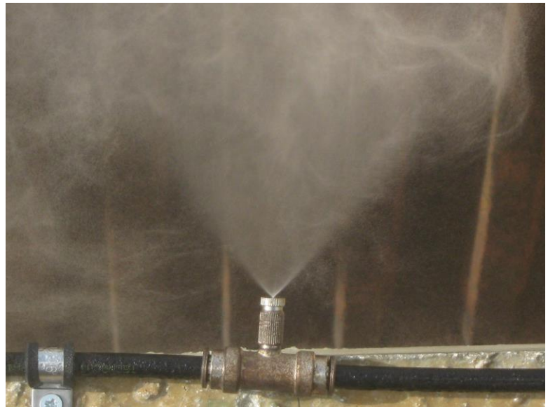
Eine Leitung mit eingebauten Düsen wurde installiert; das Bild zeigt eine einzelne Düse
