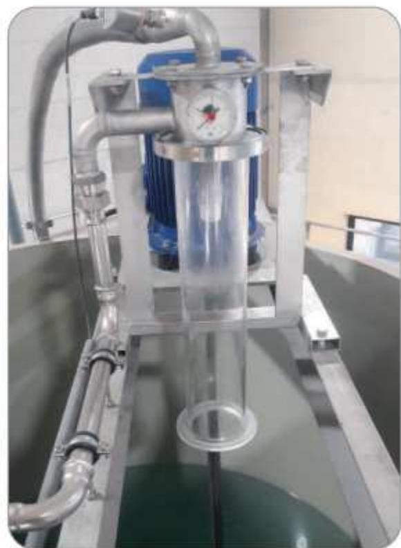
Detail der Polymerlösestation ARA Region Dornbirn-Schwarzach GmbH
