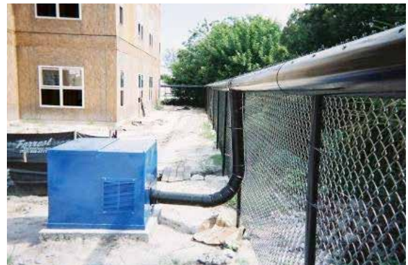
Ecosorb® Dampfphase-Anlage wird an der Umzäunung eines Geländes verwendet.
