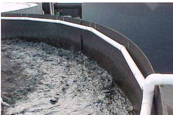
Ecosorb® Dampfphase-Anlage wird rund um große Absetzbecken verwendet.
