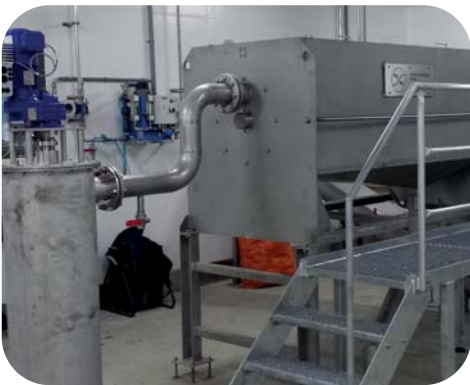
Top-Modernisierung der Kläranlage Ariolo im Tessin mit einer ACAT-Schneckenpresse der Type AS 450
